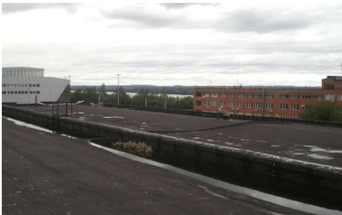
Рис. 32. Фрагменты общего вида покрытия над механическим цехом в осях И-Р и 1-27. СКОПЛЕНИЕ АТМОСФЕРНЫХ ОСАДКОВ В ЕНДОВЕ.
