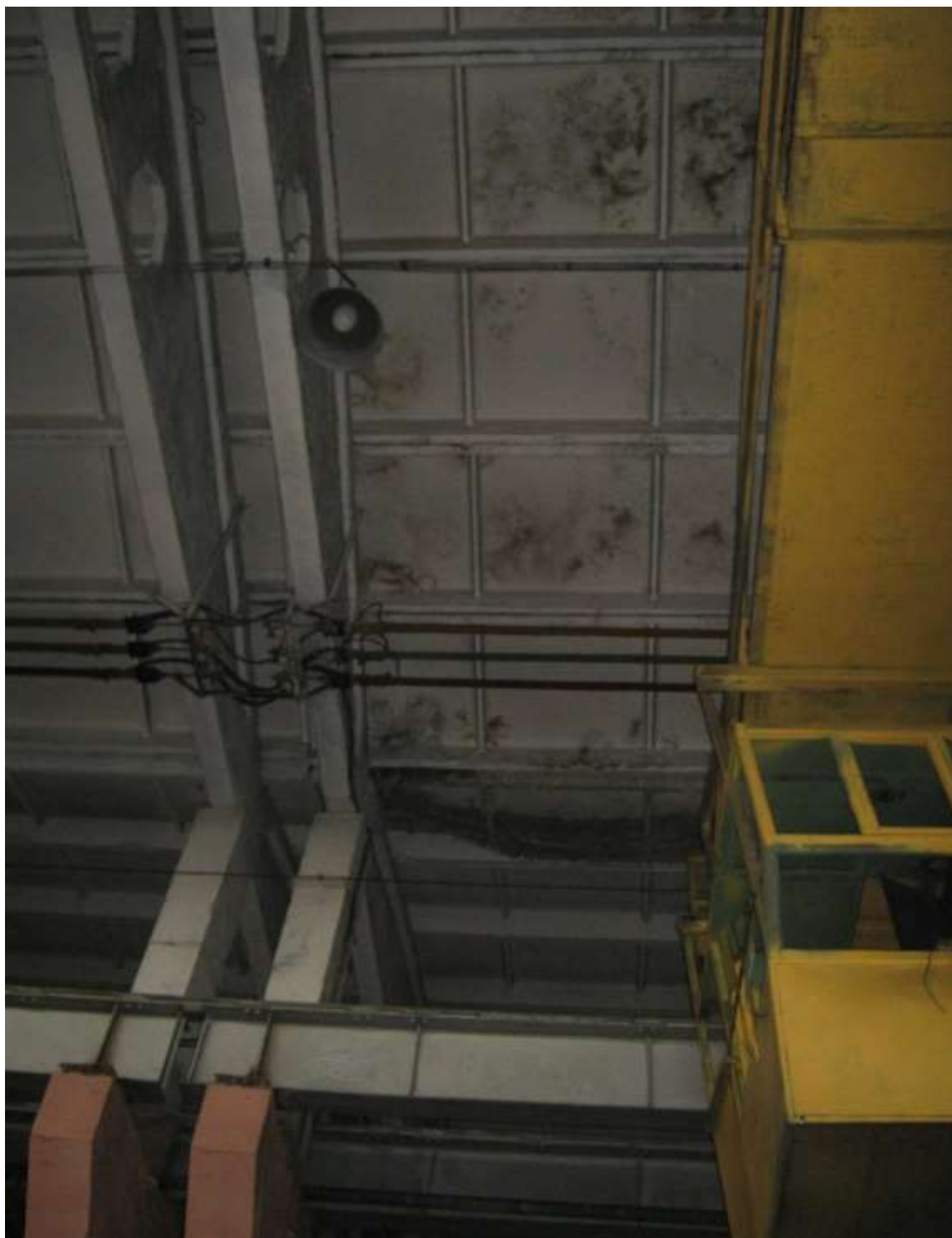
Рис. 30. Фрагменты плит покрытия со следами протечек в зоне деформационного шва.
