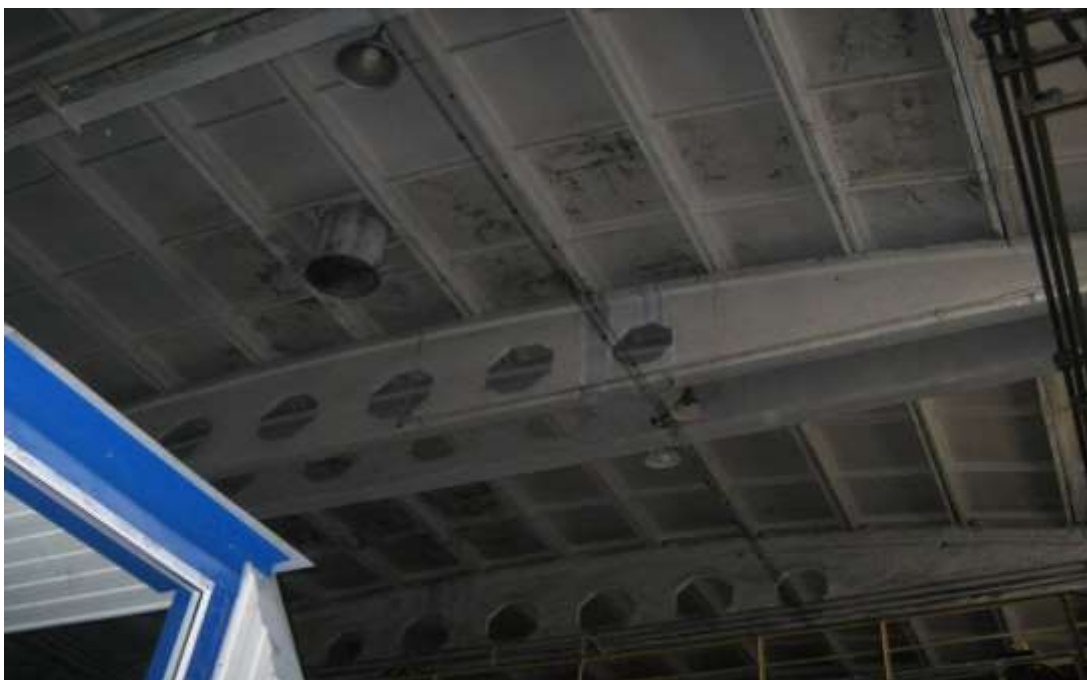
Рис. 28. Фрагменты плит покрытия со следами протечек в зоне расположения вентиляционных труб.
