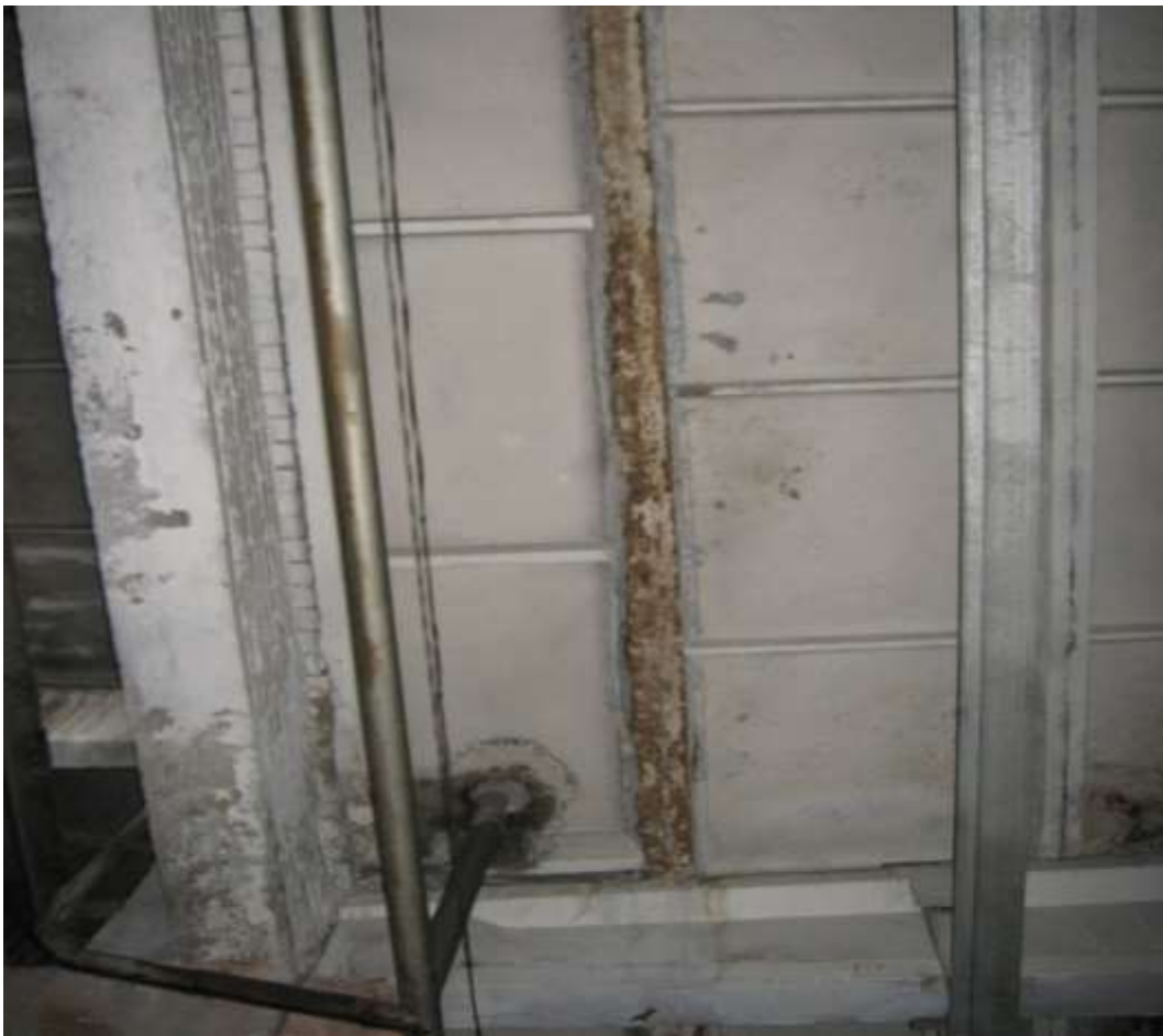
Рис. 28. Фрагменты плит покрытия со следами протечек в зоне расположения труб внутреннего водостока.
