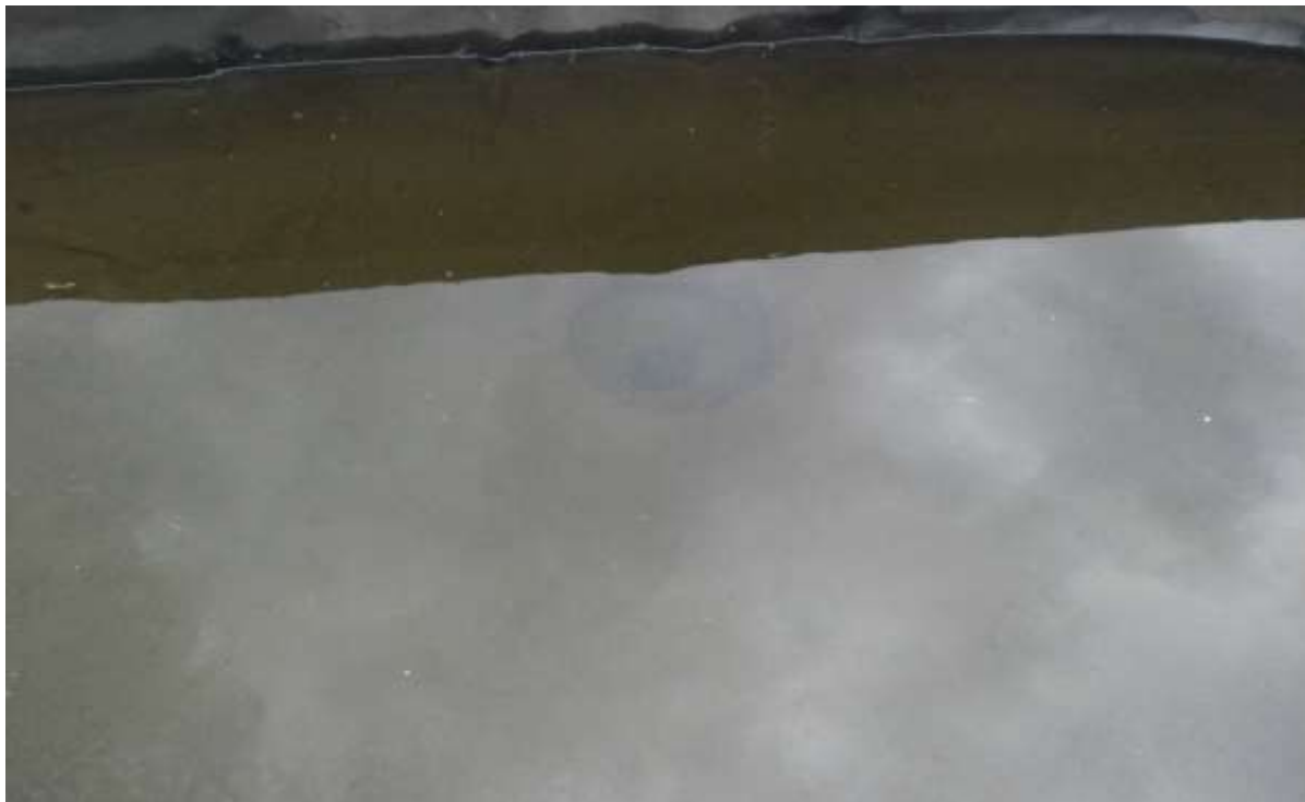
Рис. 33. Скопление атмосферных осадков в ендове, вследствие неработоспособного состояния водосточных воронок.
