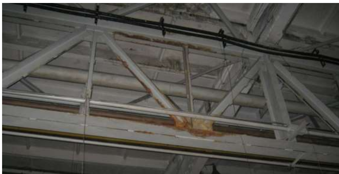
Рис. 24 Коррозия элементов подстропильных ферм.
