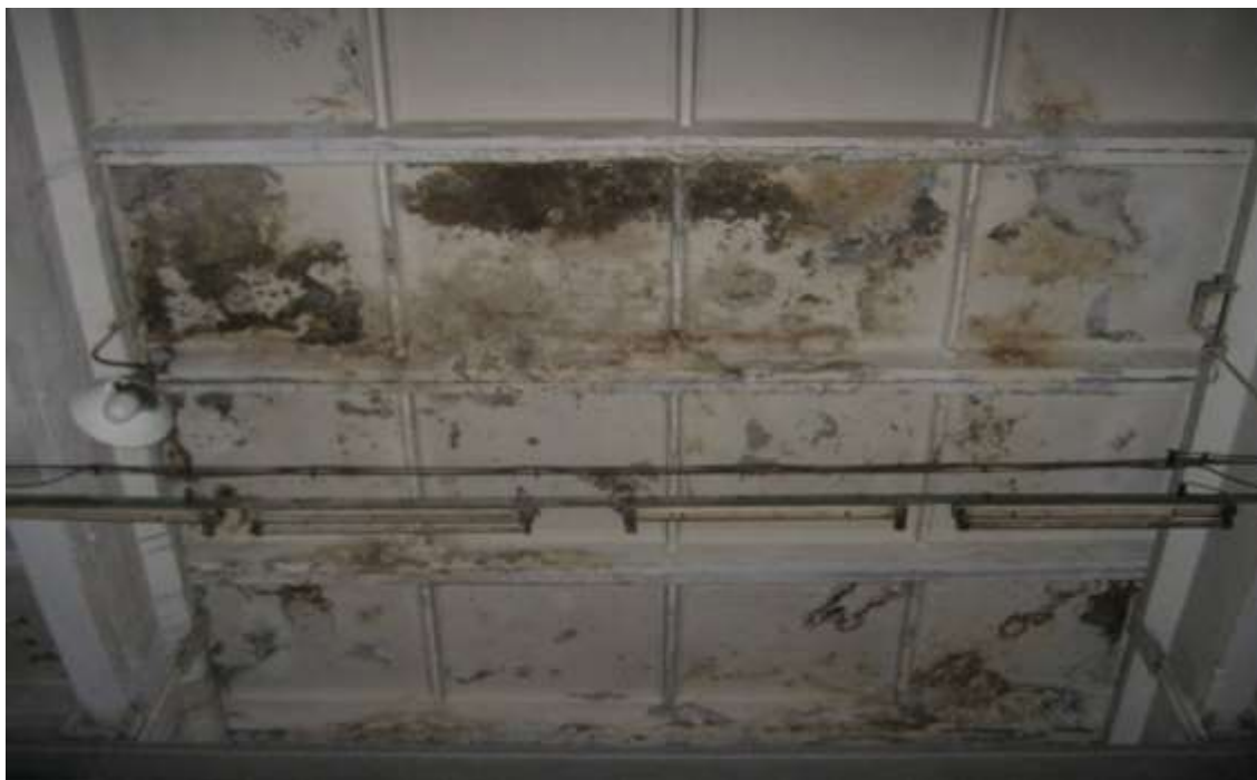
Рис. 26. Фрагменты плит покрытия в ендовах со следами протечек.
