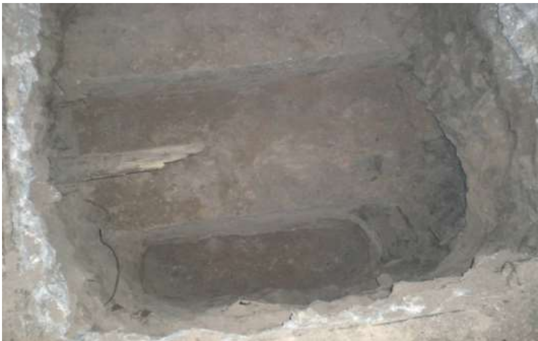
Рис.9. Результаты вскрытия шурфов для определения конструкции фундаментов под колонны среднего ряда по оси Г.
