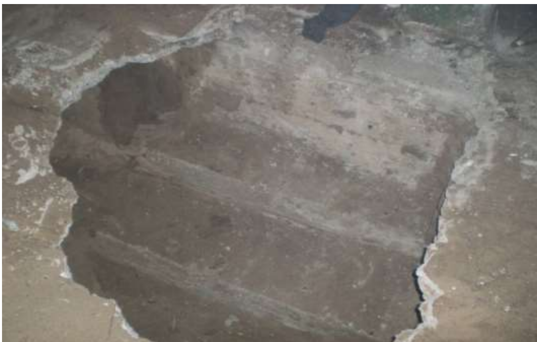
Рис.7. Результаты вскрытия шурфов для определения конструкции фундаментов под колонны крайних рядов по оси Ж и И.
