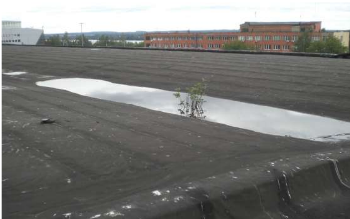
Рис. 31. Фрагменты общего вида покрытия над механическим цехом в осях А-Ж и 1-27. СКОПЛЕНИЕ АТМОСФЕРНЫХ ОСАДКОВ В ЕНДОВЕ.
