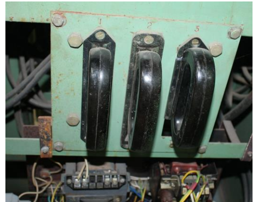
Установка максимальной ступени трансформатора («1-1-1»)
