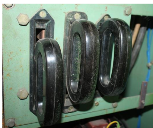
Установка номинальной (15-й) ступени трансформатора («2-1-1»)
