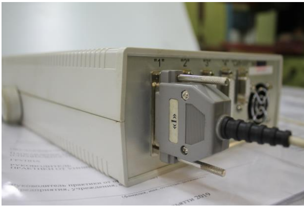
Датчик тока подключён к каналу «1» регистратора РКДП-0401
