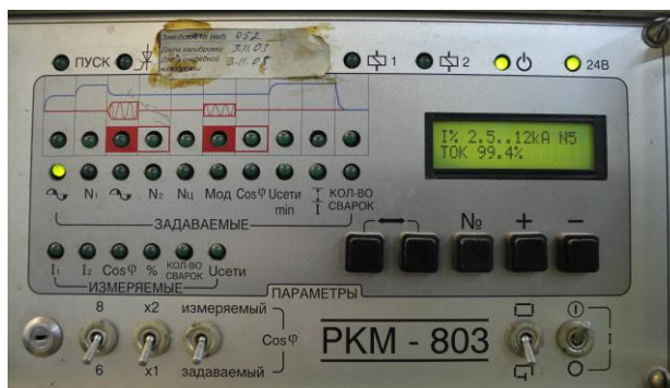
Регулятор сварки настроен на минимальный угол открытия сварочных тиристоров
