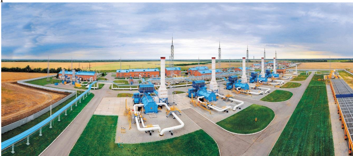
Рис. 1 Компрессорная станция «Сальская» Ростовская обл.
