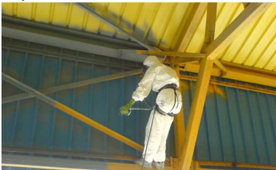
Рис. 15. Пример антикоррозионной защиты стропильной фермы и связей по ним
